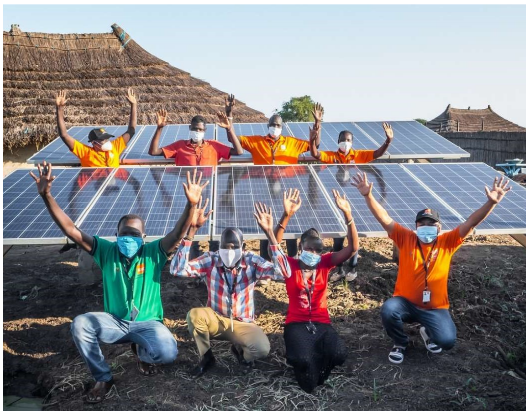
En 2020, des panneaux solaires ont été installés au bureau de NRC à Mankien, au Soudan du Sud. L'équipe dispose désormais de sa propre alimentation électrique et profite d'une énergie renouvelable 24h/24 et 7j/7. Photo : Iban Colón/NORCAP
